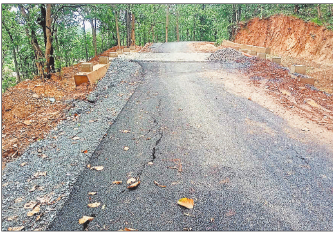
नवनिर्मित सड़क जो जगह-जगह से फटने लगी।
